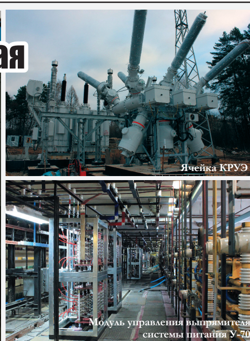
Новые сухие трансформаторы в машинном зале здания 10
